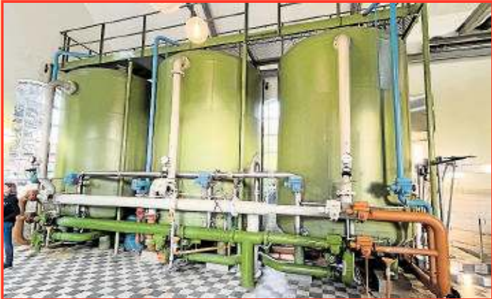
Spannende Einblicke ermöglichten die Stadtwerke Buxtehude beim Zutritt zum Wasserwerk.
